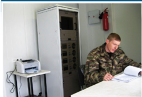
Рабочее место оператора-аккумуляторщика на ЗАС
